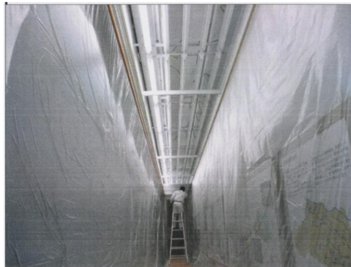
固定展示ケース内 既存照明器具取付状況
