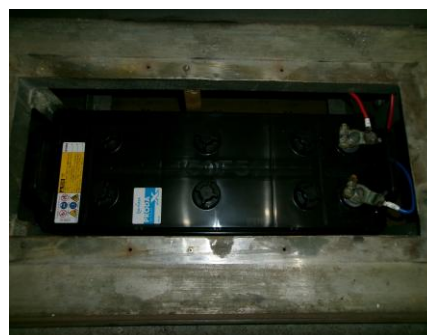
電動台車バッテリー格納部分
