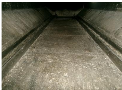
い号炉炉内レール炉床部分
